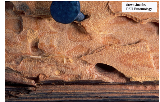
Imagen del daño hecho por el perforador de casas viejas. Haga click sobre la imagen para una exposición más amplia.
